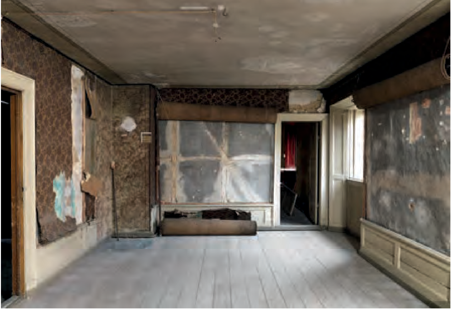
Bindingsværksvæggen i den modsatte ende af rum 203 er antagelig skillevæggen mellem de oprindelige to store rum på førstesalen. Foto: Roberto Fortuna.
