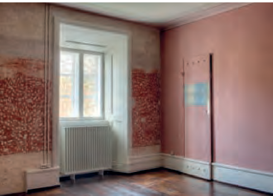
I den vestlige ende af den nye førstesal var væggene rødmaledede med sort og grå stregdekoration og illuderet fodpanel, malet næsten en halv meter op. Indhuggene er lavet senere for at sikre vedhæftning af puds. Foto: Kurt Rodahl Hoppe. Th.: udsnit af loftdekoration 2013. Foto: Roberto Fortuna.
