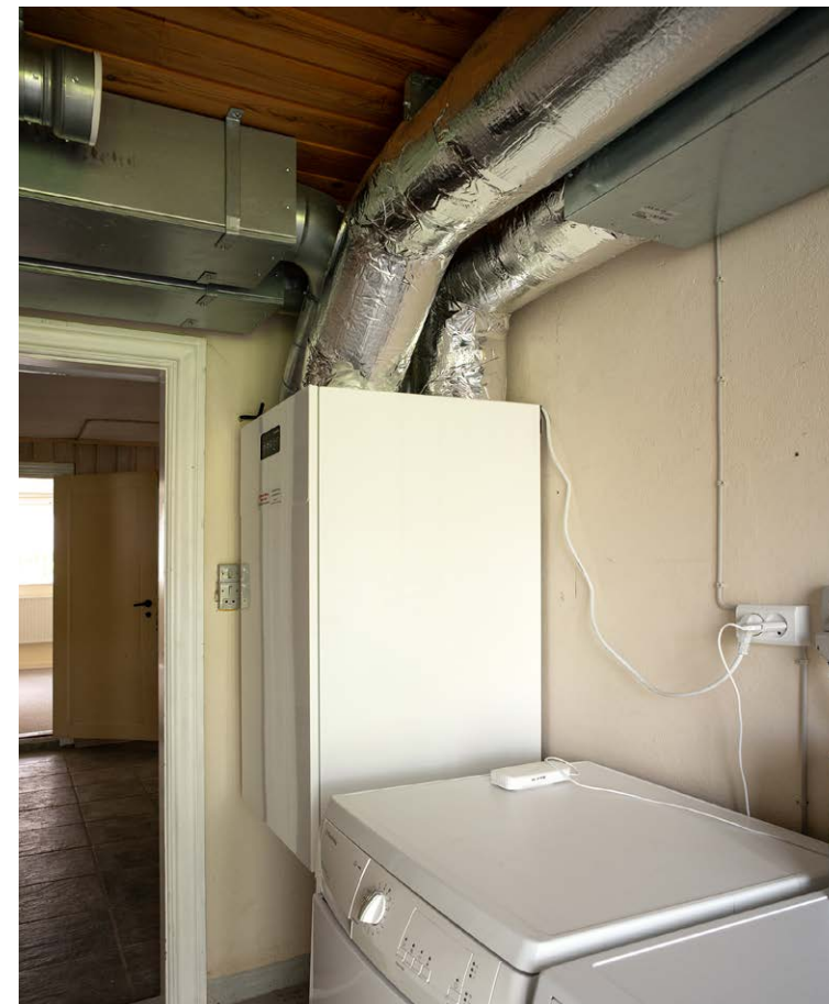
Selvom et ventilationsanlæg fylder en del, er det som regel muligt at passe det ind, især hvis man som her har kælder under huset.
